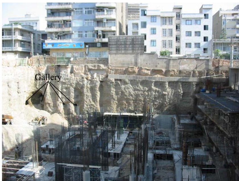
شکل شماره ۳-۲- قطع گالری یا کوره چند کاریز توسط شالوده ساختمان جدید در سال ۱۳۸۲، (به نفل از خورسندی احمد ۱۳۸۲)
