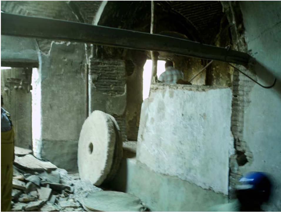
شکل شماره ۲۳-۳- آسیاب کاریز یوسف آباد و سنگ آسیابی که تخریب شده است.
